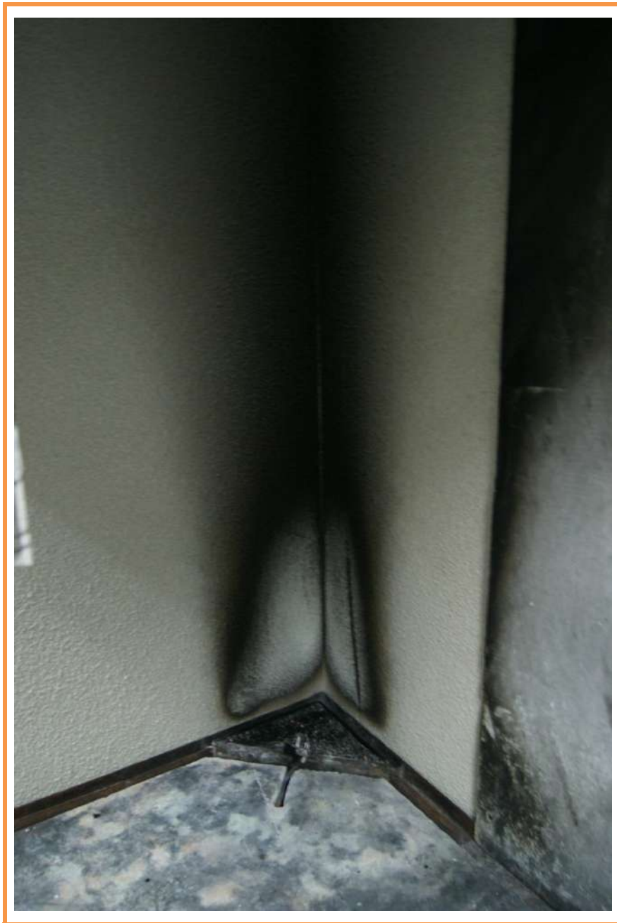
Probe nach der Prüfung
